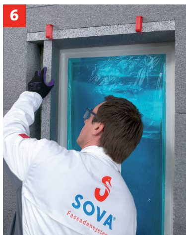
6 ... und halten die Laibungsplatte sicher an der Wand. Mit den SOVASPEED Uni clips werden die Dämmplatten fixiert, während der SOVASPEED Klebeschaum aushärtet.
